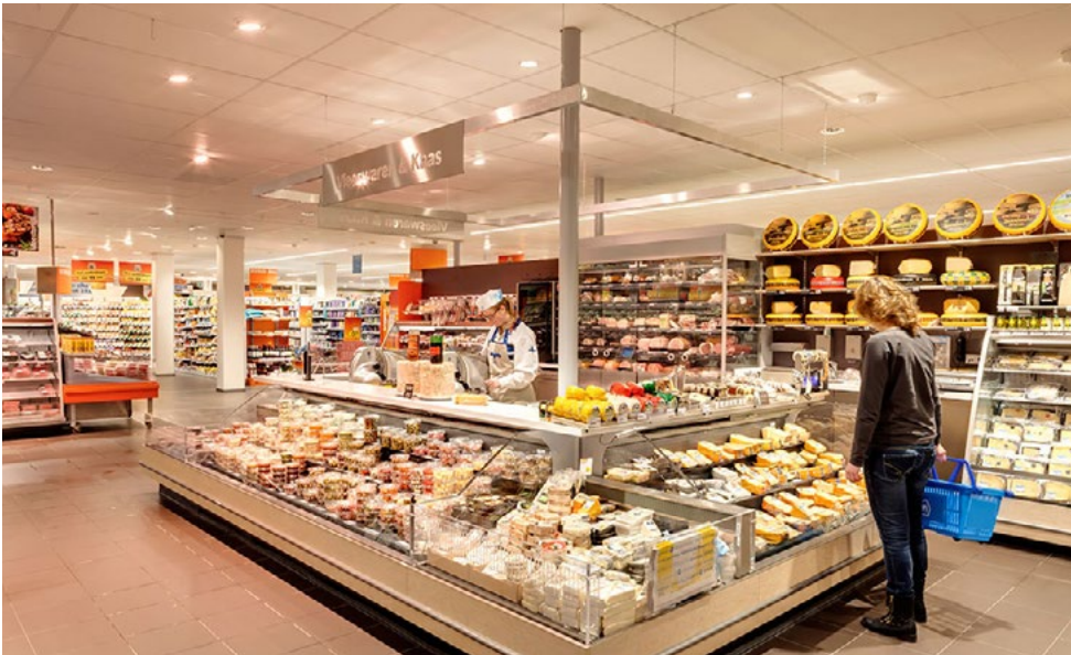
Albert Heijn supermarkt in Alkmaar heeft met LED-verlichting een geïnstalleerd verlichtingsvermogen van 10,3 W/m 2 .
