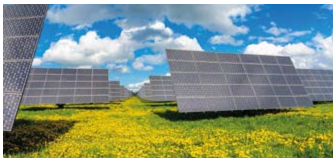
Tijdelijke energieopwekking d.m.v. zonnepanelen (ca. 150 ha.).
